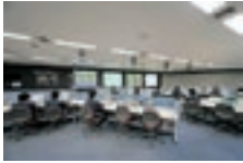
数据中心 (综合管制中心)
